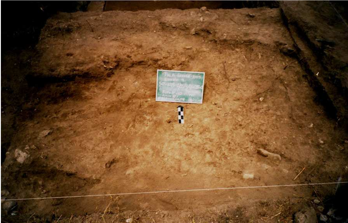
Figura 12. Detalle del núcleo de adobe como parte de la cimentación del edificio.
