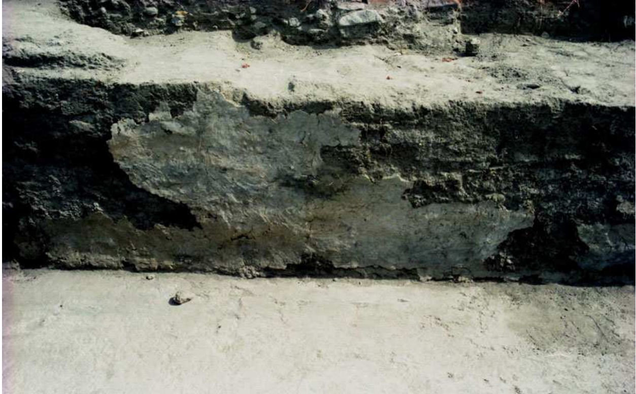
Figura 17. Estado de conservación de los muros de adobe donde se aprecia el núcleo compuesto por bloques y recubiertos con una capa de arcilla; éstos desplantan directamente de los pisos sin evidencias de banquetas.
