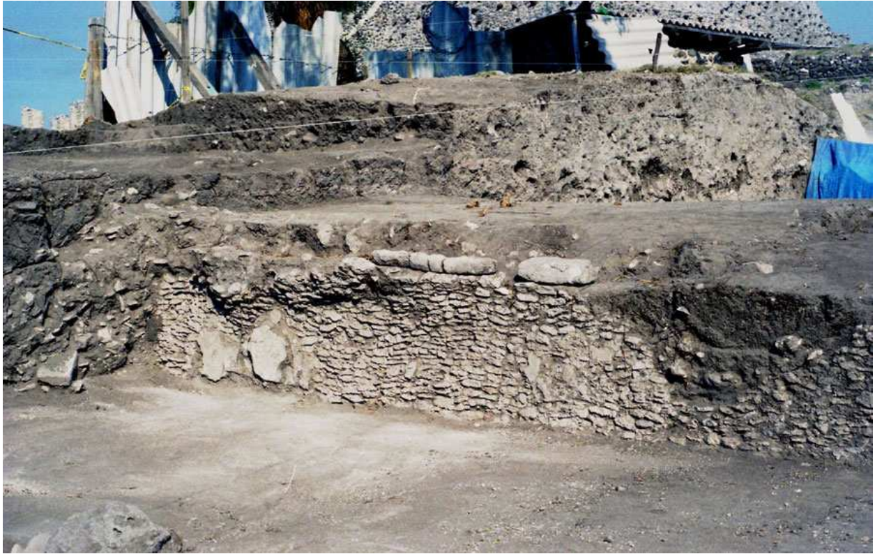
Figura 22. Estado de conservación del muro de lajas “small stone” en el límite suroeste de la estructura, en ella se observa la altura parcial delimitada por cornisas de cantera.
